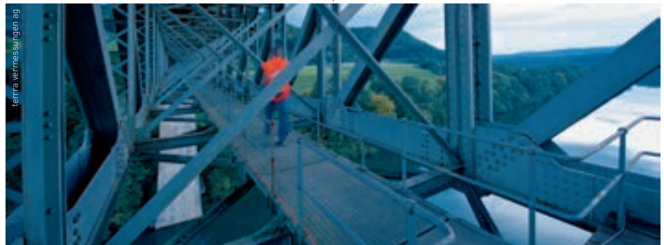
Auf der Grundlage des Langzeit-Monitorings wurden das Tragverhalten und die Ermüdungssicherheit der 90 Meter langen Stahlkonstruktion im Zentrum der Brücke beurteilt.
